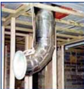
< installation sous-sol coudée
